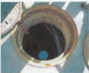
(d) 电力电缆井
